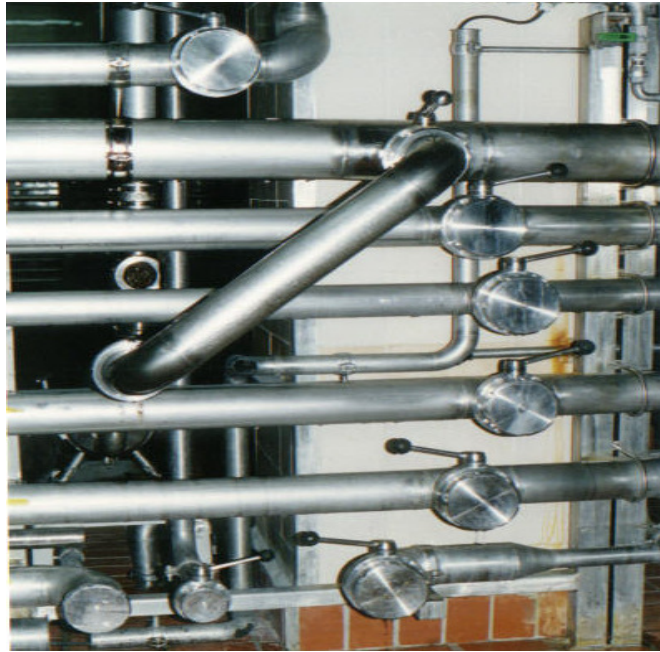
Detalle codo giratorio Bomba Tren de Barriles
