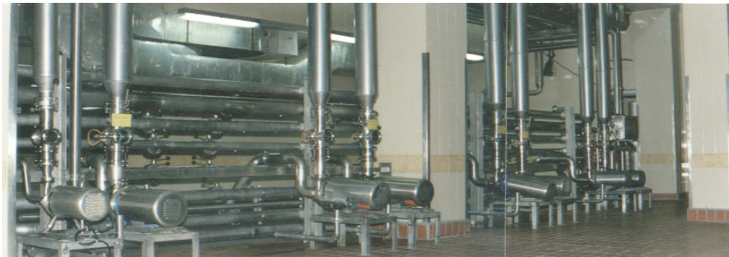
Sala de bombas para trenes de Envasado.
